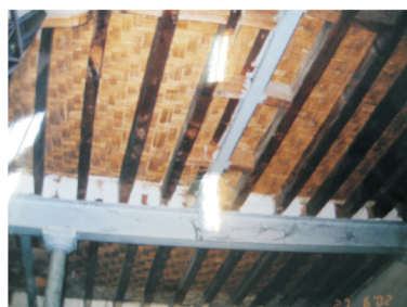
φωτ. 69: Λεπτομέρεια ταβανιού όπως ήταν το 2002 πριν από την αποκατάσταση.
